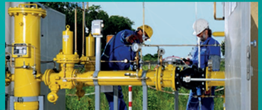
Gasdruckregelanlage (MITNETZ GAS)
